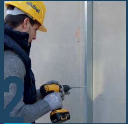
FISSAGGIO DELLA SOTTOSTRUTTURA ALLA PARETE PORTANTE FASTENING OF SUBSTRUCTURE TO BEARING WALL
