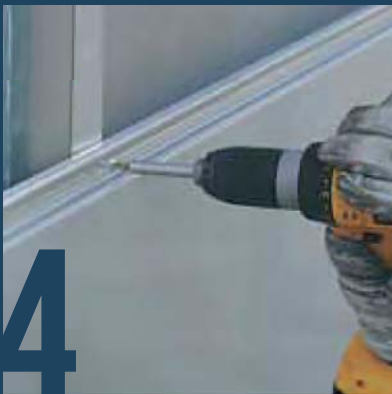
FISSAGGIO DEL PRIMO PANNELLO ALLA BASE DELLA FACCIATA FASTENING OF FIRST PANEL TO FACADE BASE
